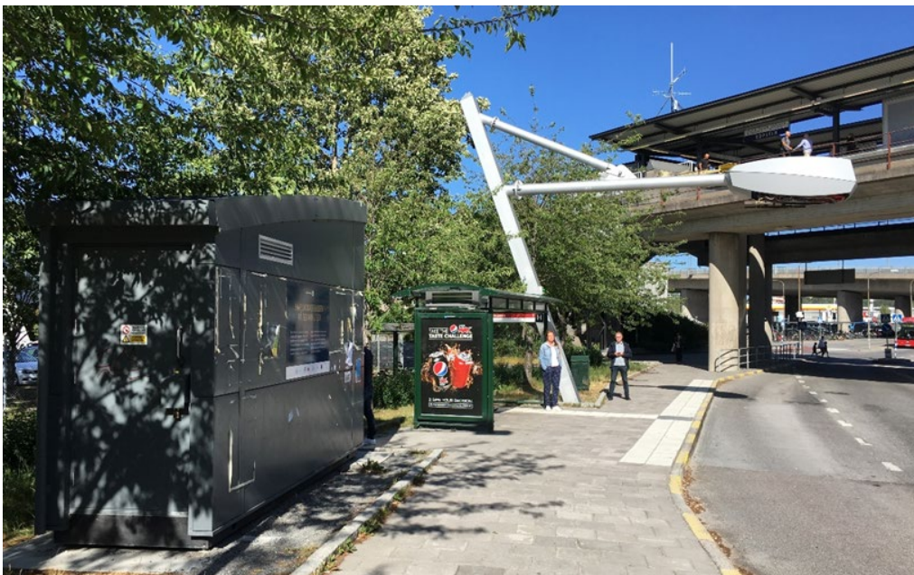
Foto som visar hållplatsläge i terminal Ropsten där elbuss kan laddas med pantograf med tillhörande likriktarstation som skymtas framför väderskydd.
