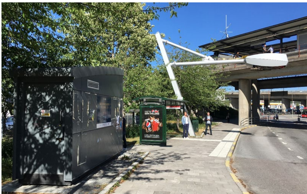
Foto som visar hållplatsläge i terminal Ropsten där elbuss kan laddas med pantograf med tillhörande likriktarstation som skymtas framför väderskydd.
